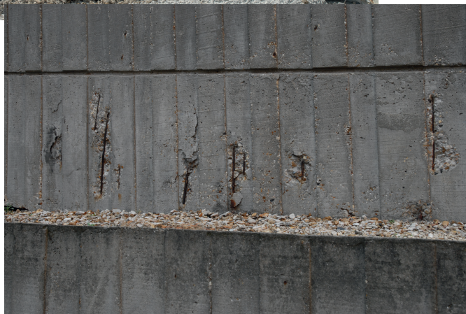
▲ Exemple de pathologies (épaufrures) sur béton armé dues à la corrosion des armatures induites par carbonatation.
