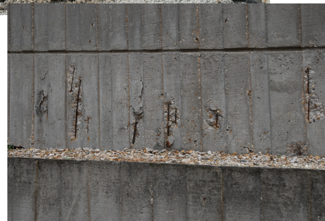
▲ Exemple de pathologies (épaufures) sur béton armé dues à la corrosion des armatures induites par carbonatation.
